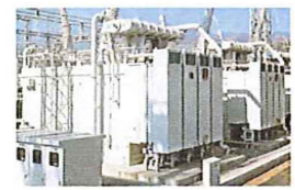
起動変圧器の例
